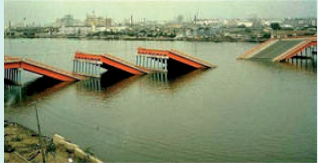
FIGURA 5 Effetti della liquefazione su un ponte a Niigata nel 1964 [2]
