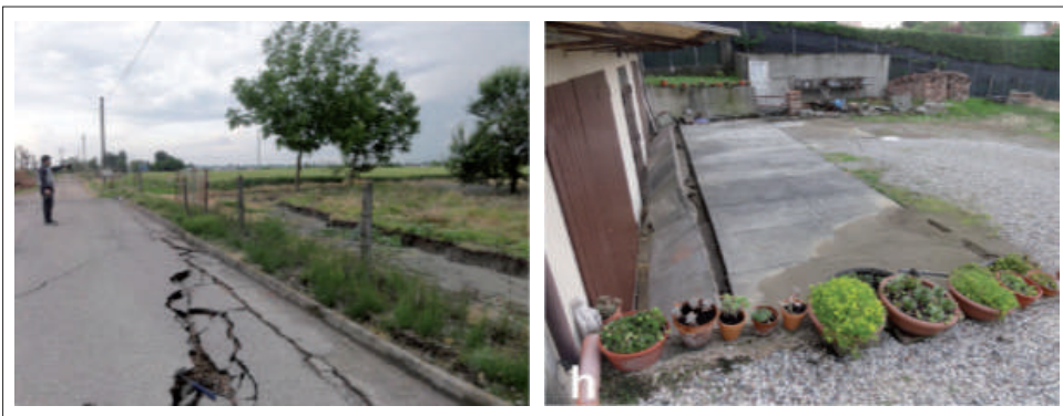
FIGURA 2 Effetti della liquefazione su manufatti a seguito del sisma in Emilia [5]
