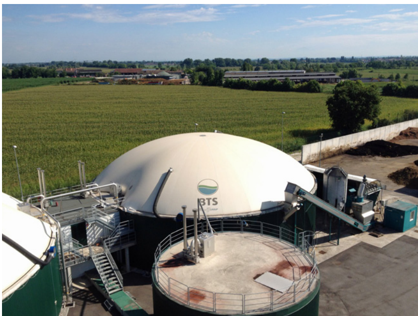
Impianto di biogas da 1 MW che consente di valorizzare gli scarti e i sottoprodotti derivanti dalle attività agricole e dall'allevamento bovino dell'azienda agricola Chiesa (Asolo, Mantova)
