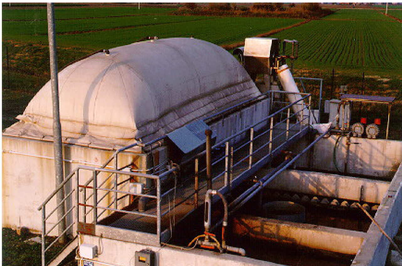
Fig. 3 Impianto di depurazione di Biancolina (Bologna); sulla sinistra il primo Anaerobic Baffled Reactor (ABR) in Italia per la digestione anaerobica del liquame progettato dall'ENEA
