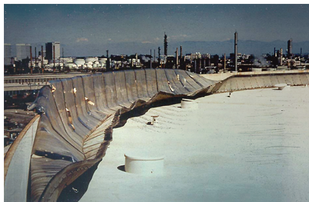
FIGURA 8 Danneggiamento del tetto di un serbatoio cilindrico a causa dello sloshing
