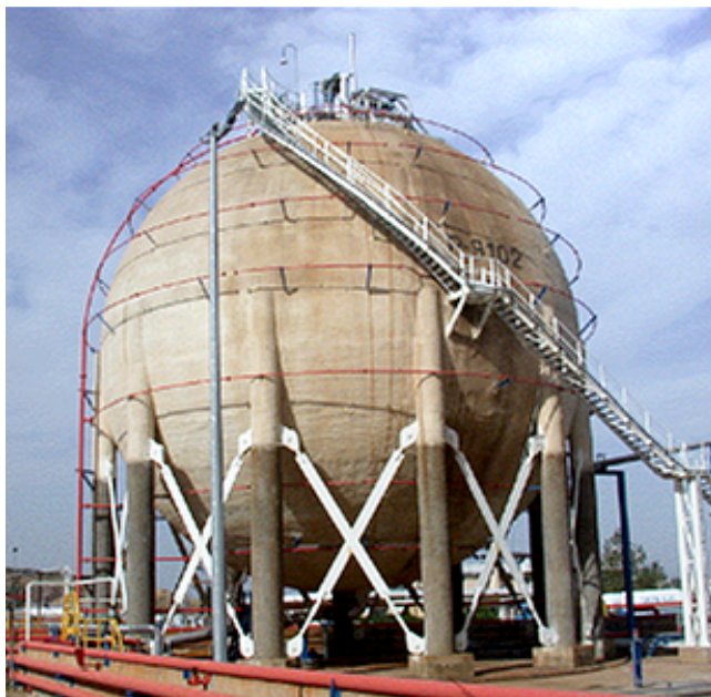
FIGURA 5 Retrofit con controventi su di un serbatoio sferico nella raffineria di Aspropirgos (Grecia)
