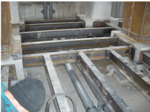
FIGURA 6 Graticcio delle travi in acciaio a collegamento dei pulvini. Si può notare che anche l'impiantistica passa nel vano tecnico ed è ispezionabile (Condominio Pianola)
