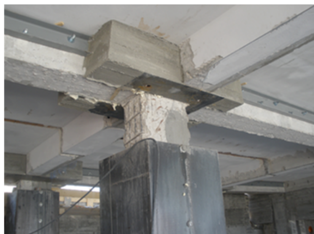
FIGURA 4 Pulvino superiore, è visibile il conco del vecchio pilastro che dovrà essere tagliato per inserire l'isolatore, mentre sotto è visibile la parte superiore della camicia in acciaio di rinforzo del pilastro (Condominio Pianola)
