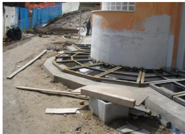
FIGURA 8 Particolare della struttura del gap lato valle, realizzato da "spicchi" metallici rimovibili (Condominio Pianola)
