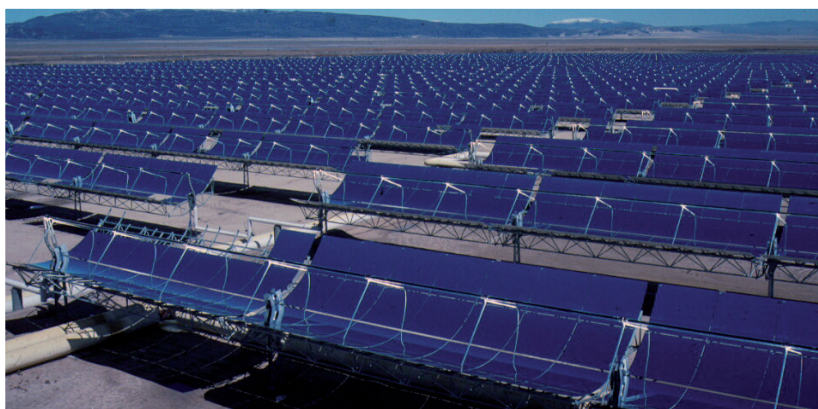
FIGURA 2 Impianto commerciale a collettori parabolici lineari (SEGS – USA)
