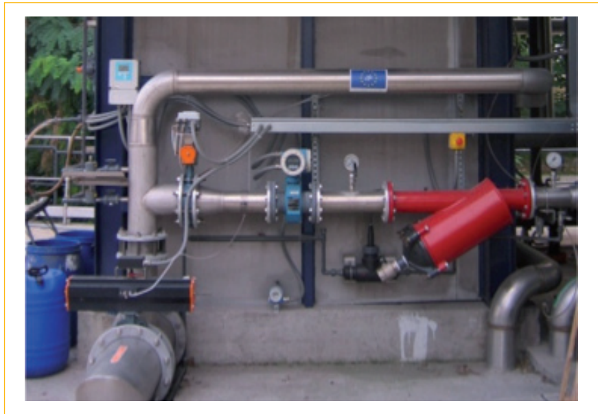
FIGURA 4 Impianto realizzato da ENEA in collaborazione con i partner nell'ambito di detto progetto.
