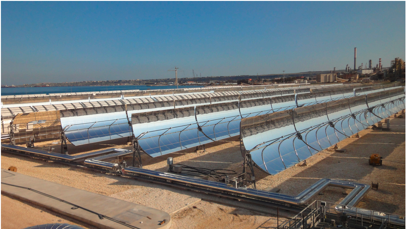
FIGURA 3 La centrale solare termodinamica "Archimede" di Priolo Gargallo (Siracusa). L'impianto è integrato in una centrale elettrica a cicli combinati a gas dell'Enel
