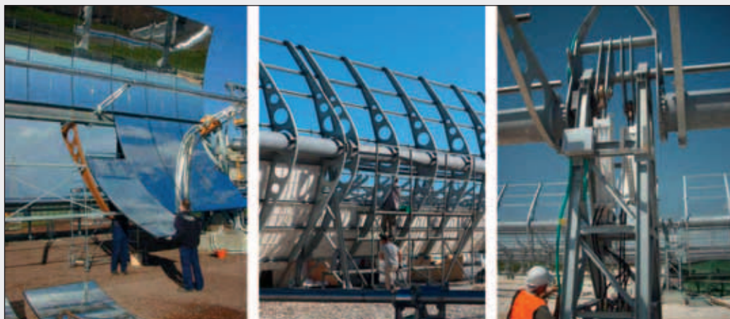
Figura 6 Montaggio e regolazione del concentratore parabolico lineare e del sistema oleodinamico di movimentazione Fonte: foto ENEA
