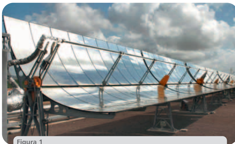
Figura 1 Impianto solare a concentrazione a collettori parabolici lineari ( parabolic trough ) Fonte: foto ENEA
