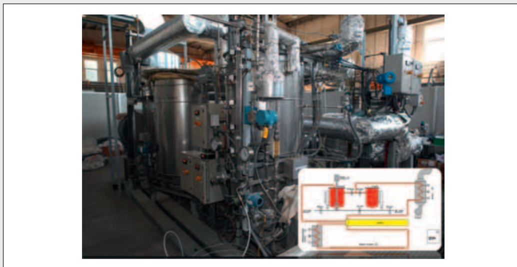
Figura 14 Impianto MOSE Fonte: foto ed elaborazione grafica ENEA
