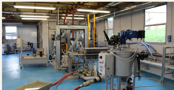
Una panoramica dell'impianto ROMEO
