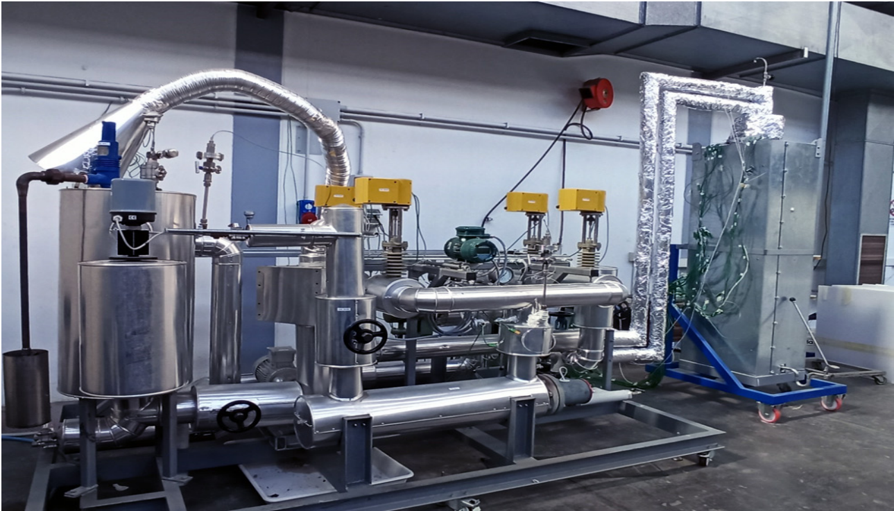
Fig. 2 Immagine dell'impianto sperimentale Solteca3 nel Centro Ricerche ENEA Casaccia
