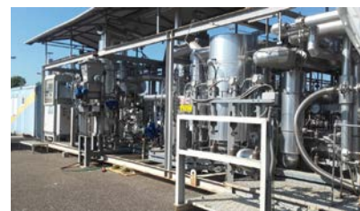
▲ Impianto pilota di gassificazione rifiuti per la produzione di un gas ad alto contenuto di idrogeno
