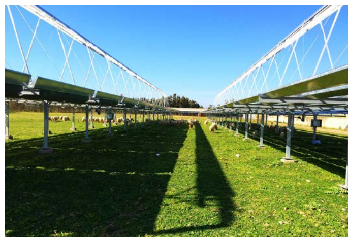
Nuova Sarda Industria Casearia Impianto solare a concentrazione progettato da CSP-F SpA per la produzione di calore di processo industriale
