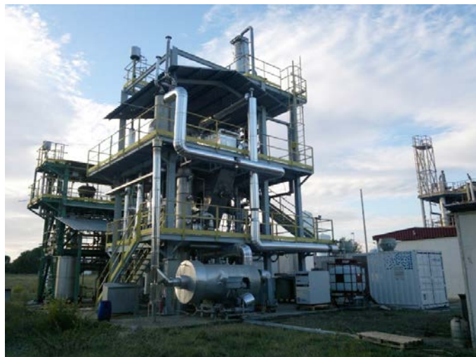
Impianto di gassificazione dell'infrastruttura PIBE
