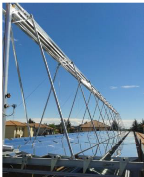
Esempio di test on-site di un collettore a concentrazione
