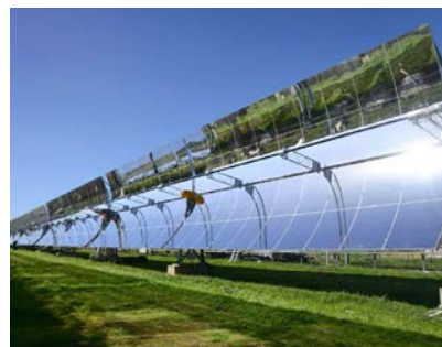
Vista del collettore solare
