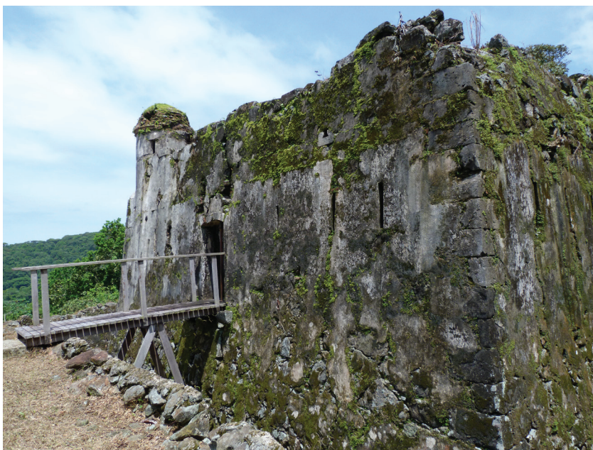
Fig. 2 Biodegrado sulle murature della Fortezza di San Lorenzo, Panama
