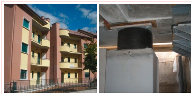
FIGURA 10 Esempio di recente riparazione di un edificio italiano con l'isolamento sismico: il complesso edilizio di Via dei Tigli 6-8-10 a Pianola (L'Aquila) ed uno dei 42 HDRB che, assieme a 67 SD, costituiscono il sistema d'isolamento (progetto del compianto socio del GLIS Ing. Giuseppe Mancinelli e del membro del consiglio direttivo dell'associazione Ing. Daniele Corsetti; certificato di collaudo in corso d'opera rilasciato dallo scrivente in maggio 2014
