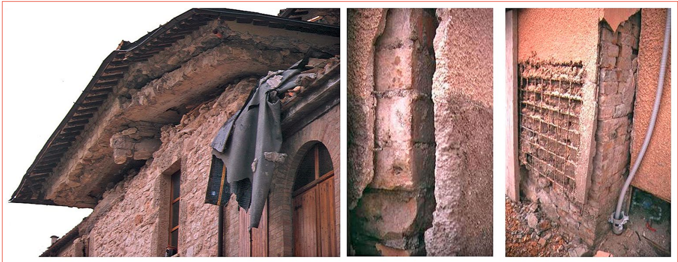
FIGURA 4 Sellano (PG), 1997, terremoto Umbria-Marche. A sinistra: scorrimento del piano della copertura: in occasione di un intervento pre-sisma, la copertura tradizionale era stata sostituita con una copertura più rigida e pesante; nessun intervento di rinforzo era stato eseguito sulle strutture verticali in muratura. A destra: gli effetti dell'evento su strutture verticali irrigidite con paretine armate
