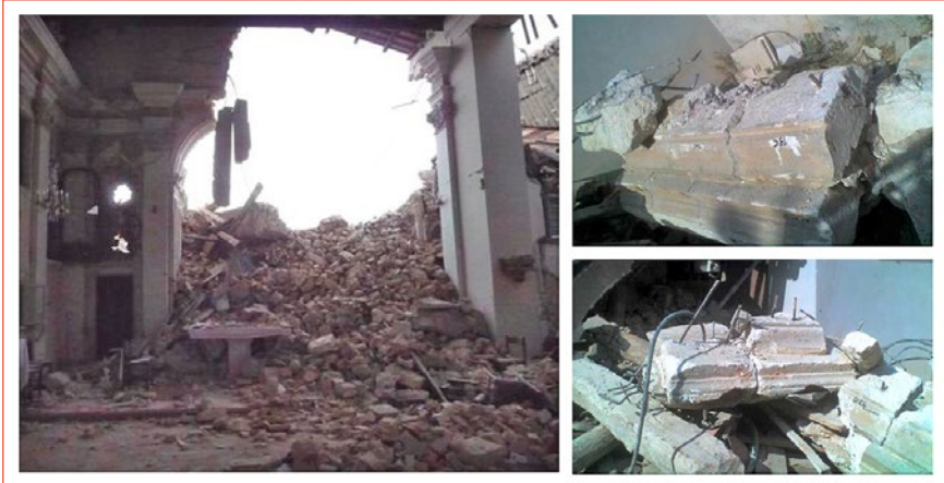
FIGURA 6 Chiesa di San Pietro Apostolo Onna (AQ), 2009, terremoto de L'Aquila: particolare dell'area di crollo invasa dalle macerie in corrispondenza della zona absidale e presbiteriale; intervento con cuciture armate risultato inefficace
