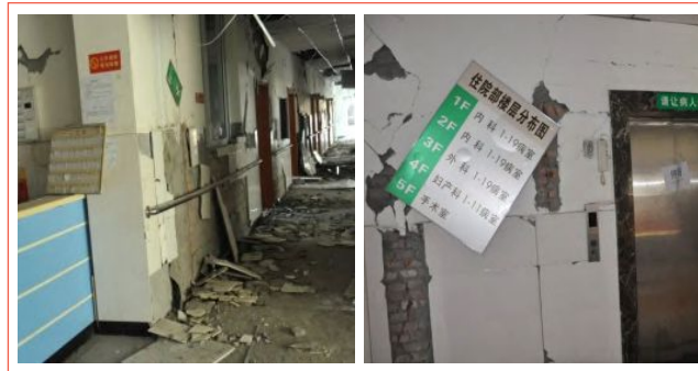
FIGURA 17 Danni causati dal terremoto di Lushan del 2013 agli interni dei due edifici fondati convenzionalmente dell'ospedale di Figura 16 Fonte: Zhou et al., 2013; Martelli et al., 2014a
