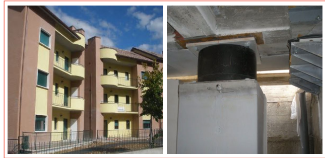
FIGURA 10 Esempio di recente riparazione di un edificio italiano con l'isolamento sismico: il complesso edilizio di Via dei Tigli 6-8-10 a Pianola (L'Aquila) ed uno dei 42 HDRB che, assieme a 67 SD, costituiscono il sistema d'isolamento (progetto del compianto socio del GLIS Ing. Giuseppe Mancinelli e del membro del consiglio direttivo dell'associazione Ing. Daniele Corsetti; certificato di collaudo in corso d'opera rilasciato dallo scrivente in maggio 2014
