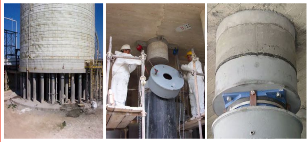
FIGURA 13 Uno dei tre serbatoi della Società Polimeri Europa del Gruppo ENI situati a Priolo, che furono adeguati sismicamente mediante isolatori statunitensi FPS negli anni 2005-2008, ed un FPS durante e dopo la sua installazione; questa è l'unica applicazione italiana dell'isolamento ad impianti e componenti chimici RIR nota allo scrivente (prima del sisma in Abruzzo del 2009 gli risultava anche l'unica applicazione in Italia di isolatori CSS) Fonte: Martelli et al., 2014a
