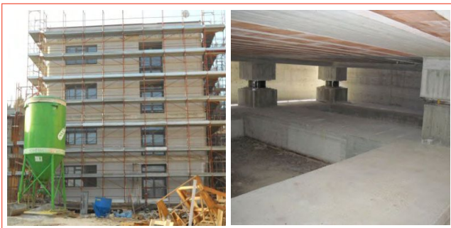
FIGURA 9 Il nuovo edificio B del Liceo Scientifico Romita a Campobasso (ex zona sismica 2), ricostruito con l'isolamento sismico (12 HDRB e 10 SD) dopo la demolizione degli edifici A e B nel 2010 (essi si erano dimostrati insicuri a seguito di prove sui materiali costruttivi effettuate dall'ENEA nel 2003; l'edificio è stato collaudato dallo scrivente nel 2013 Fonte: Martelli et al., 2014a
