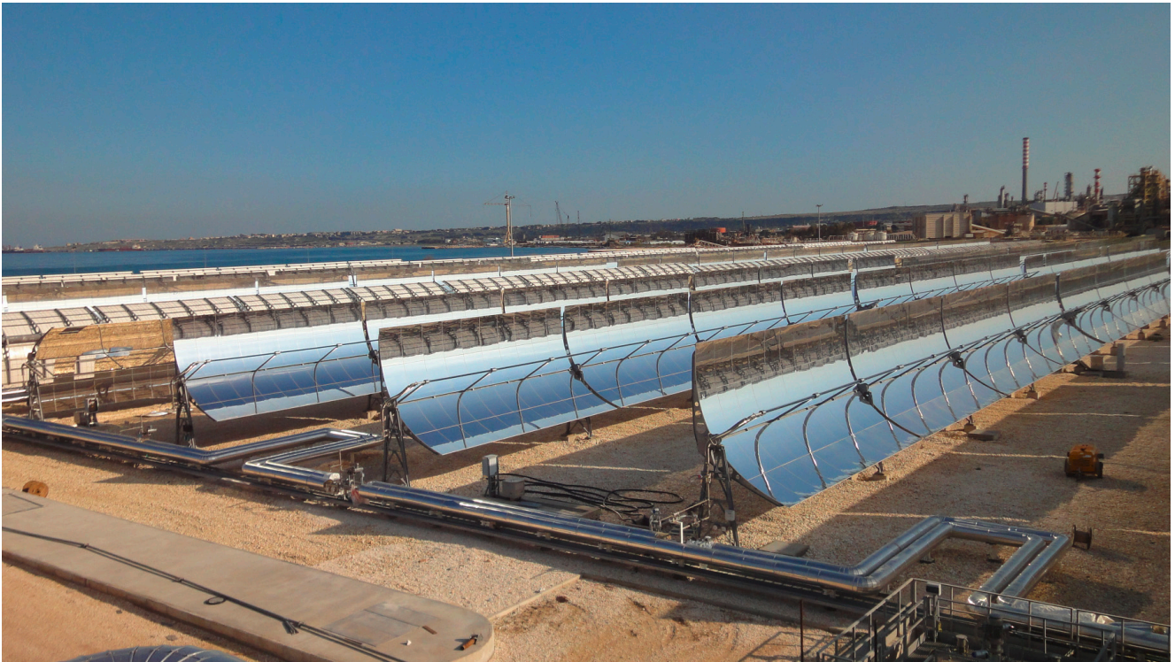
FIGURA 3 La centrale solare termodinamica "Archimede" di Priolo Gargallo (Siracusa). L'impianto è integrato in una centrale elettrica a cicli combinati a gas dell'Enel
