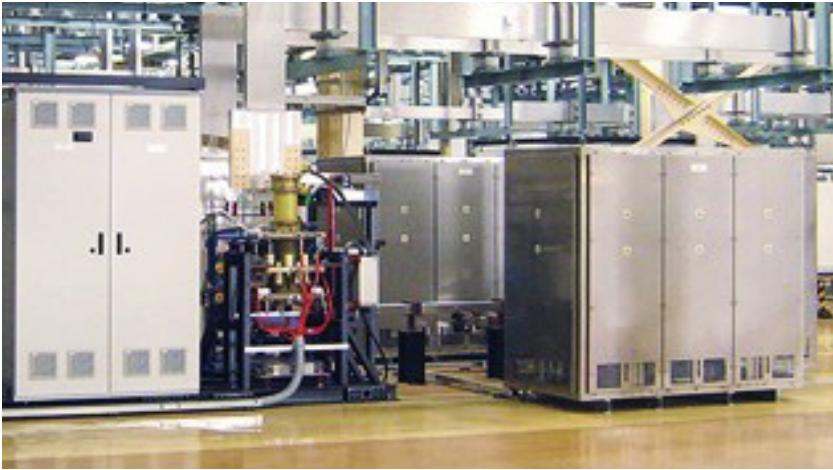
Fig. 2 Sistema di protezione del magnete superconduttore fornito dal Consorzio RFX di Padova per il tokamak JT-60SA di Naka, in Giappone
