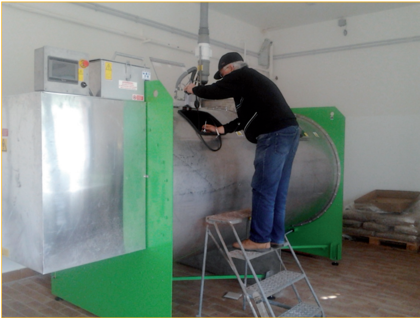
FIGURA 1 Un compostatore di comunità installato presso il Centro ENEA della Casaccia (2013)
