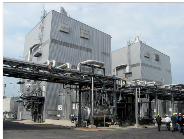
FIGURA 3 Impianto per la produzione di biodiesel della capacità produttiva di 400.000 t/anno della Biopetrol Industries AG, Rotterdam (NL), maggio 2009 Fonte: immagine di proprietà dell'autore
