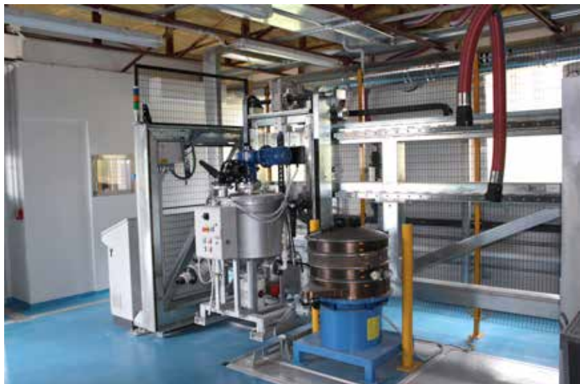
Particolare dell'impianto dimostrativo ROMEO (Recovery Of MEtals by hydrOMetallurgy) realizzato nel Centro Ricerche Casaccia, dedicato al recupero e alla separazione di materiali da matrici complesse per via idrometallurgica
