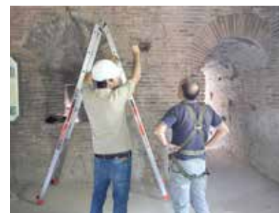
Installazione di sensori sulle antiche Mura Aureliane di Roma per monitorare gli effetti di smog e traffico
