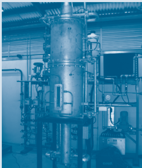
Figura 5 Impianto IDEA per la combustione dell'H 2 Fonte: ENEA
