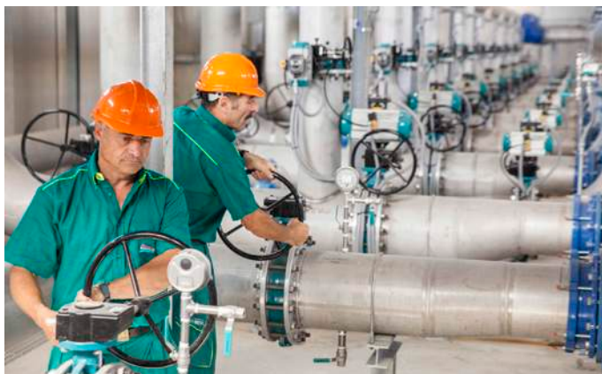
Impianto di depurazione municipale di Rimini (Gruppo Hera)
