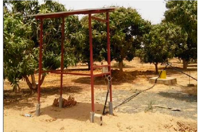
Pannelli fotovoltaici per il pompaggio dell'acqua dai pozzi. L'acqua estratta rifornisce i serbatoi utilizzati nei sistemi di irrigazione goccia a goccia per gli orti
