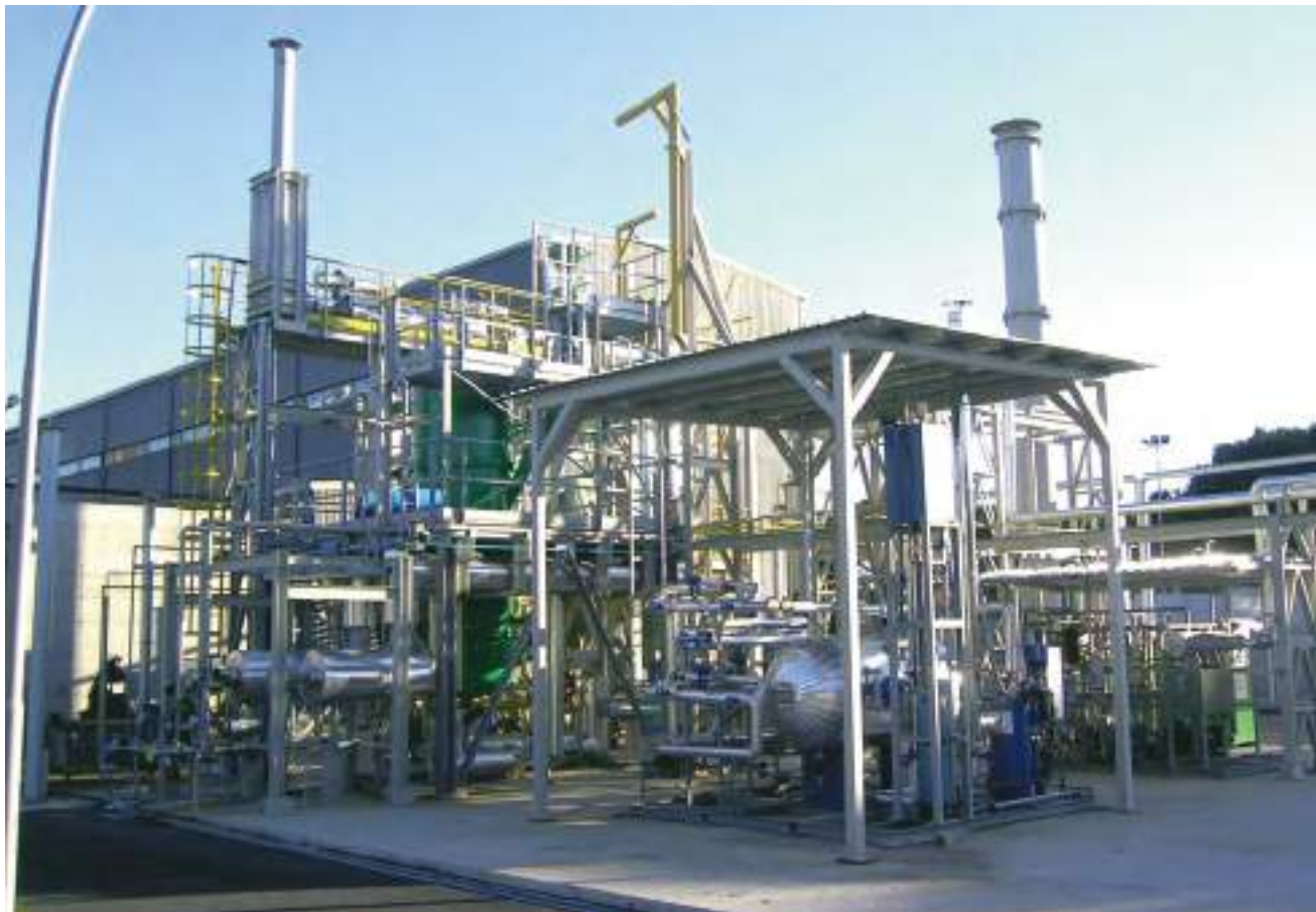
FIGURE 15 L'impianto ZECOMIX al termine della fase 1 Fonte: ENEA
