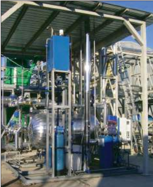
FIGURA 12 Generatore di vapore con annesso sistema di produzione acqua demineralizzata Fonte: ENEA
