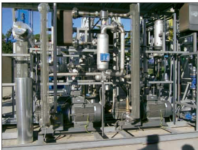
FIGURA 13 Sistema di compressione a tre stadi interrefrigerato Fonte: ENEA
