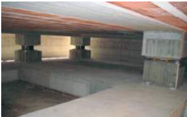
FIGURA 1 Isolatori sismici della nuova scuola Romita di Campobasso Fonte: ENEA
